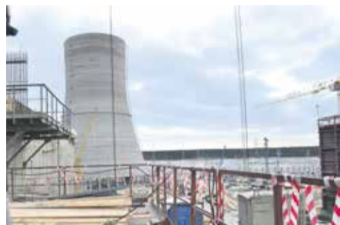
Градирня Нововоронежской АЭС-2. Высота 175м.
